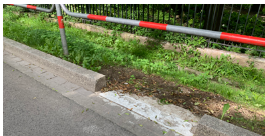
Usunięty krawężnik realnie odciąża odwodnienie ulicy (fot. RetencjaPL)
