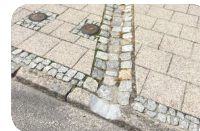
fot. 22. Tym wybrukowanym korytkiem woda z rynny spływa na ulicę. /Jacek Zalewski, RetencjaPL/
